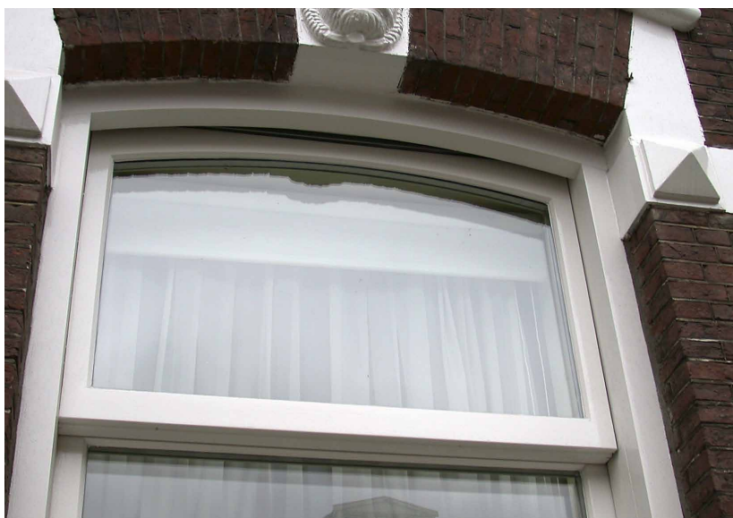
Foto voorzijde De vensters van dit voormalige bakhuis zijn geïsoleerd door achterzetbeglazing aan te brengen. Dit is zo uitgevoerd dat de karakteristieken van het stalvenster niet aangetast zijn en er ventilatie mogelijk is gebleven
