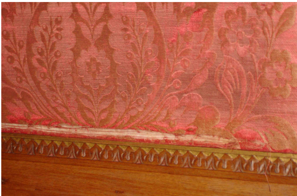
Gebruiksschade aan een wandbespanning
