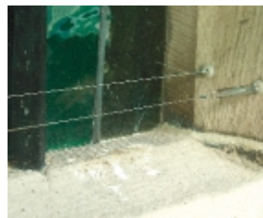
Afgeveerde draden die te hoog zijn aangebracht. De duiven kunnen er, gelet op de uitwerpselen, onder roesten
