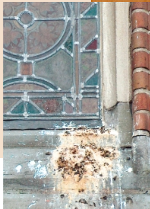
Duivenpoep op een monument: niet alleen vervuילend, maar ook schadelijk
