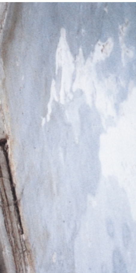
Overmatig vochtbelaste metselwerkconstructies zijn veelal de bron voor de aantasting van houtconstructies (foto Koning & Bienfait)
