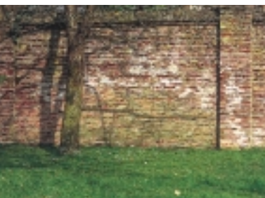
Een drogende muur staat vocht en zouten af aan de buitenlucht (foto M. van Rooden)
