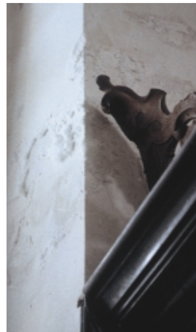
Een sluier van zout op pleisterwerk (foto Koning & Bienfait)
