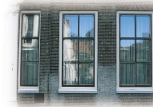
Visuele schade door het opbrengen van een antigraffiti-laag.
