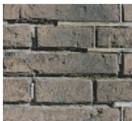
Losgelaten cementvoegen. Schade als gevolg van onjuiste verwijdering van voegen. De res- tanten van oude kalkvoegmortel zijn nog plaatselijk aanwezig.
