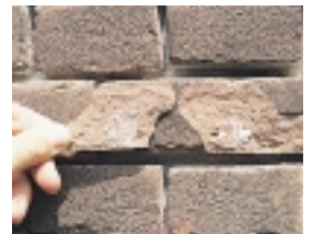
Losgelaten baksteenschilfer, veroorzaakt door de verplaatsing van het zout naar het oppervlak.
