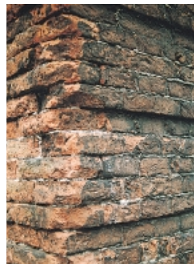
Detail van de gevel vóór het herstel met reparatiemortel.
