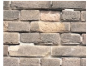
Baksteen waarvan schilfers zijn afgesprongen als gevolg van zoutbelasting.
