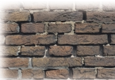
Het in kalkspecie gemetselde werk stoot de cementvoeg af, waardoor de open voegen kunnen leiden tot vochtoverlast.
