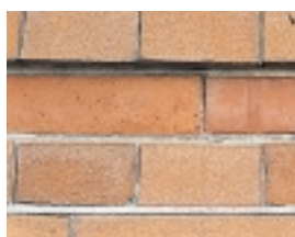
Detailopname van gestraalde baksteen. De toplaag is wegge- straald.
