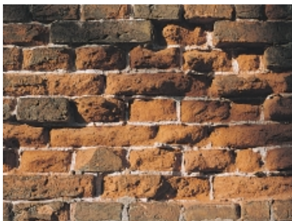
Door vocht en zouten aangetast metselwerk.
