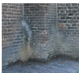
Schade aan metselwerk als gevolg van onjuist gebruik door urineren.
