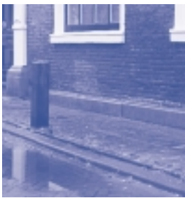
Op niet onderhouden bestrating blijven de plassen te lang staan.
