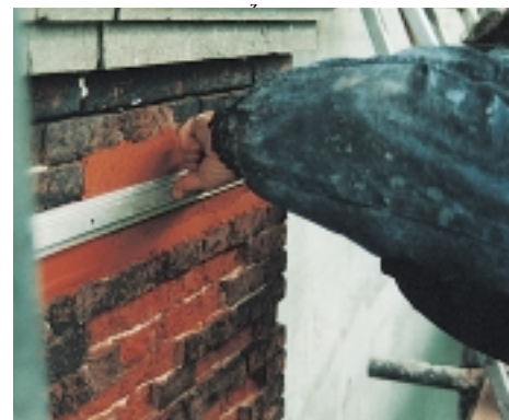
Detail van de gevel met opgebrachte reparatiemortel en daaronder een gedeelte waar de reparatiemortel nog opgebracht moet worden.
