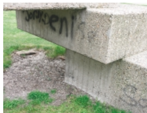
Door verwerking van beton verdwijnt de egale cementbuid en komt het toeslagmateriaal grind bloot te liggen. Het verschil tussen beschutte en niet-beschutte vlakken is duidelijk zichtbaar
