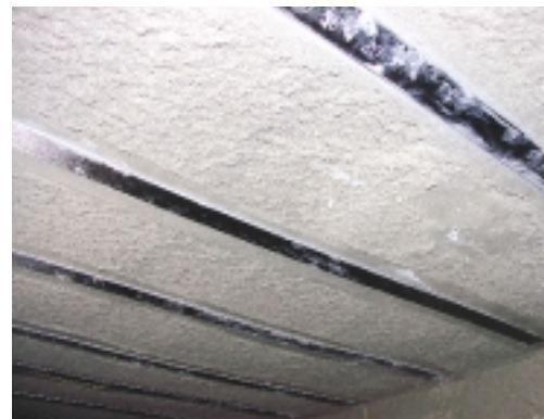
Door het aanbrengen van een dunne laag spuitbeton en gelijkde, geprefabriceerde koolstofvezelwapening is de onderzijde van de betonvloer beschermd tegen verdere aantasting en versterkt
