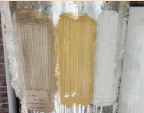
Proefvlakken waarmee onder andere de verwerkbaarheid, kleur en hechting van verschillende samenstellingen kunnen worden beoordeeld
