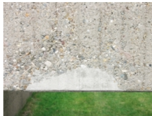
De reparatie steekt duidelijk af bij het verweerde oppervlak. Men had de reparatieplek visueel beter kunnen laten aansluiten door bijvoorbeeld het nog niet volledig uitgeharde oppervlak even te borstelen
