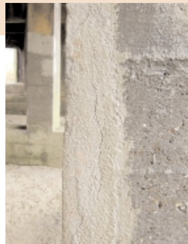
Voorbeeld van minder fraai en weinig duurzaam herstel met een kunstbarsegebonden materiaal. Het gebruik van volledig kunstbarsegebonden materialen wordt door de Rijksdienst voor de Monumentenzorg in het algemeen ontraden
