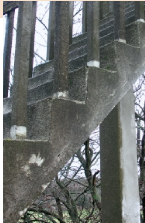
Een dunne scheur verraadt dat de extra laag spuitbeton loskomt die tien jaar geleden is aangebracht tegen de onderzijde van deze trap. Een goede hechting van hangend herstelwerk is een kritisch punt. Verbindingswapening, een goede hechtbrug en een optimale materiaalkeuze zijn uiterst belangrijk
