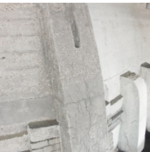
Na het stralen van de betonnen koepel uit 1981 van de watertoren in Zutphen is plaatselijk craquelé zichtbaar. Deze scheuren zijn niet ernstig, maar voor de levensduur van het verfsysteem is het raadzaam ze op te vullen met minerale mortel
