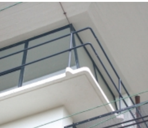
Balkonrand van het recent gerestaureerde seinhuis Post T uit 1935 bij het station in Maastricht, van Sybold van Ravesteyn. De van oorsprong kwetsbare detaillering, waarbij de ijzeren balusters door de uitstekende betonnen nokken heen liepen, is aangepast. Een voorbeeld van zorgvuldig herstel, waarbij onderhoudstechnisch het detail sterk is verbeterd, terwijl het karakteristieke beeld is behouden
