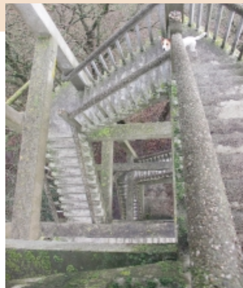
Belvédère te Oranjerwoud, hier in 2005, is gebouwd in 1924. Door onvoldoende dekking van de wapening is er veel schade ontstaan. In 1993 zijn de kolommen en de onderzijde van de trappen voorzien van een extra laag spuitbeton en is er een aantal balusters vernieuwd. Na ruim tien jaar is er onderhoud nodig
