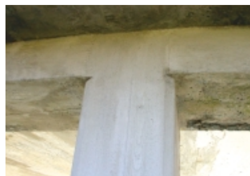
Betonreparatie waarbij de houtstructuur weer is teruggebracht door houten delen tegen de nog natte mortel aan te drukken
