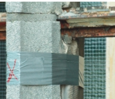
Detail van een glas-in-loodvenster. Het roestende, T-vormige brugijzer heeft de natuurstenen montant kapot gedrukt. Bij restauratie wordt het T-ijzer vaak vervangen door een beter afwaterende, rechthoekige brugstaaf met deklat
