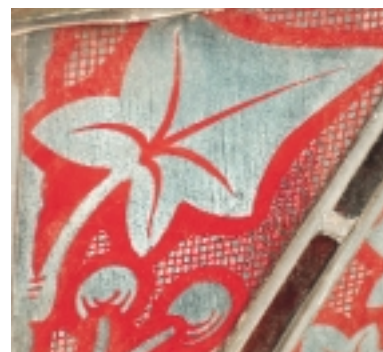
Dit wit uitgeslagen glas is het gevolg van een reiniging met een te agressief middel, dat ook nog eens onvoldoende is verwijderd, waardoor de aantasting van het glas zich na de reiniging voortzette. De krassen in de witte laag zijn het gevolg van reiniging met een te harde borstel
