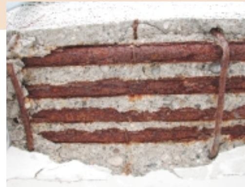
De betondekking is eraf gedrukt door het roesten van de wapening. Typend beeld van carbonatatieschade als gevolg van onvoldoende betondekking
