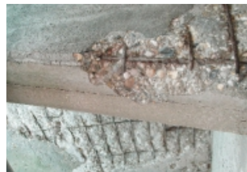
Schade aan een console onder een brugdek, dat is gebouwd omstreeks 1930. Het beschadigde beton is weggehakt. Carbonatatie en chloride hebben geleid tot aantasting van het beton en de wapening (foto R. Polder, TNO Bouw, Delft)
