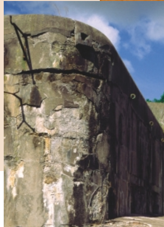
De dunne toplaag van cementmortel op het beton van Fort bij Spaarndam is deels losgelaten en lokaal zijn afzettingen van calciumcarbonaat te zien. Het fort is gebouwd rond 1900 als onderdeel van de Stelling van Amsterdam (foto Gert Jan Luijendijk)
