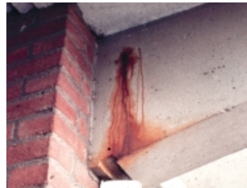
Console van een woongebouw met schadeverschijnselen die wijzen op aantasting door chloride. De chloriden zijn in dit geval ingemengd in het beton en tasten de hoofdwapening aan (foto R. Polder, TNO Bouw, Delft)
