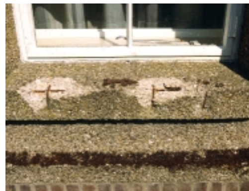
Schade door roestende wapening aan een prefab lijstelement van gewassen grindbeton. Het beton is relatief gevoelig voor aantasting, doordat het poreus is en plaatselijk een geringe dekking heeft
