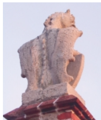
Een van de betonnen Art Nouveau-beelden op het Rooms Catholieke Vereenigingsgebouw te Franeker uit 1909, van architect Nicolaas Adema. Het oppervlak is verweerd en hier en daar is de wapening bloot komen te liggen (foto Adema Architecten, Dokkum)
