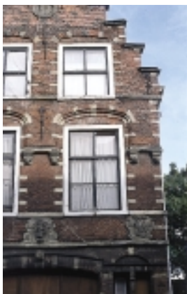
Woonhuis op de hoek van een steeg. Instabiliteit van het huis wordt onder andere veroorzaakt door de positie aan het eind van de rij en het doorgebroken zijn van de ondergevel
