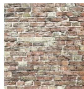
Detail van een torenwand met baksteenvullingen in een ander formaat steen, waardoor de mogelijkheid van een inboeting wordt beperkt. De venstervulling staat voor een deel los van het omringende werk
