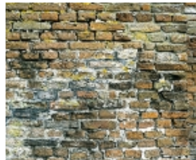
Metselwerk in kruisverband, deels verstoord door inboetwerk en cementspecie
