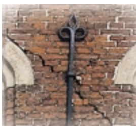
Detail van de gevel hierboven. Het metselwerk is gescheurd als gevolg van uitwijking van de bouwmassa naar de steegzijde en het maken van een groter venster
