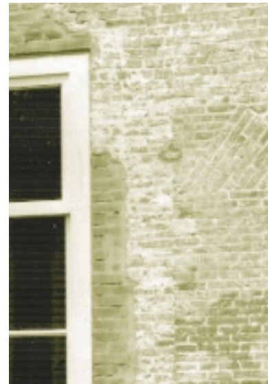
Inboetwerk zonder aansluiting met het verband van het omliggende metselwerk (foto RDMZ, 1989)
