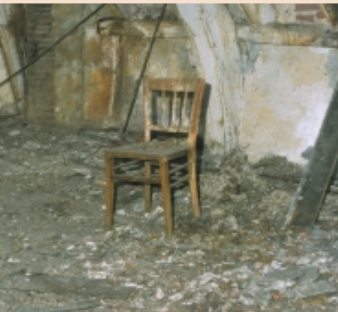
Ontoelaatbare vervuiling, die het onmogelijk maakt om gezond en goed te kunnen inspecteren
