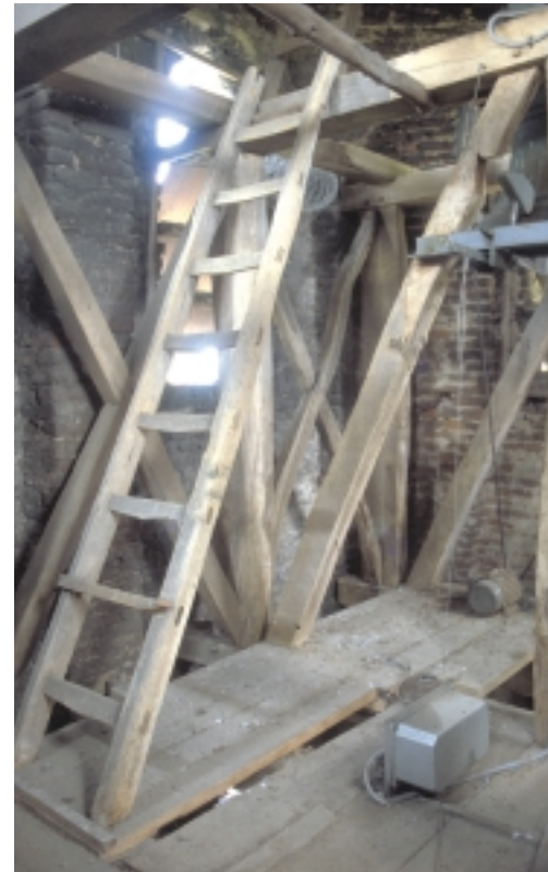
Slechte vloeren, trappen en ladders vormen een aanzienlijk risico. Bij historische trappen en ladders is herstel echter uitgangspunt
