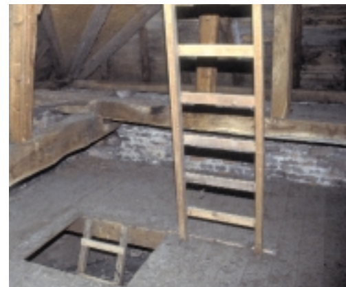
Open trapgaten, zoals deze, moeten altijd voorzien zijn van een hekwerk. Een andere mogelijkheid is het dichtleggen met een luik
