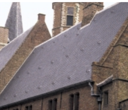
Bij dit dak zijn langs de goot en op de dakvlakken ladderhaken aangebracht. Niet alleen voor inspectie door de Monumentenwacht, maar ook voor het onderhoud door de leidekker
