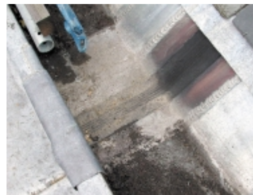
Waar een broekstuk niet mogelijk is, wordt een rubberen expansiestuk toegepast. Dit heeft echter een beperkte levensduur en gaat op den duur barsten vertonen
