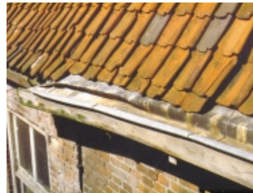
Een zinken goot met puntslijtage onder de afdruppelpunten van de dakpannen. Gaatjes zijn, zoals te zien is, uiteindelijk het gevolg (foto K. Boeder)
