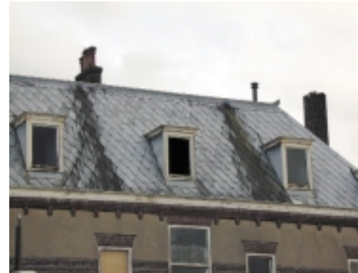
Dakbedekking met zinken losanges. De uitloop van het platte dak met bitumen en grind tekent zich af als donkere strepen en kan leiden tot plaatselijke aantasting
