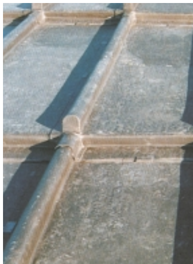
De platen van een loden dakbedekking kunnen verticaal ook aan elkaar worden bevestigd met een roef. Anders dan bij zink, waar de roef hoekig is, is de roef bij lood rond om scheurvorming te voorkomen (Bron: Lood in de bouw, SIBL 1983)
