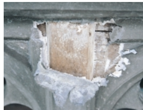
Lood wordt aan de achterzijde aangetast door condens en zuren uit het achterliggende eikenhout. Het lood wordt dan omgezet in loodoxide, ook wel loodwit genaamd. Doordat de aantasting niet zichtbaar is, is het lood vaak bijna geheel omgezet en is de schade groot
