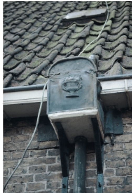
Historische vergaarbak met ornament aan de voorzijde. Behoud staat voorop, de scheur boven het ornament is dan ook geen reden om deze bak te vernieuwen. Reparatie is mogelijk en heeft de voorkeur
