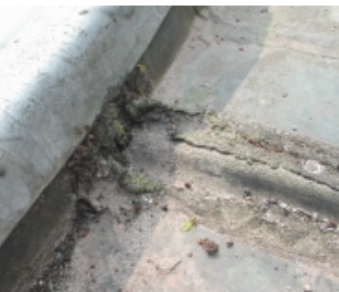
Waar een broekstuk niet mogelijk is, wordt een rubber expansiestuk toegepast. Dit heeft echter een beperkte levensduur en gaat op den duur barsten vertonen. De foto toont een gebarsten expansiestuk
