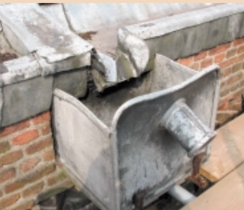
Detail van een loden goot met broekstuk (linksboven), uitloop en een vergaarbak met verklikker (het buisje aan de voorzijde). De vergaarbak is ondersteund met hout op ijzeren beugels om uitzakken te voorkomen
