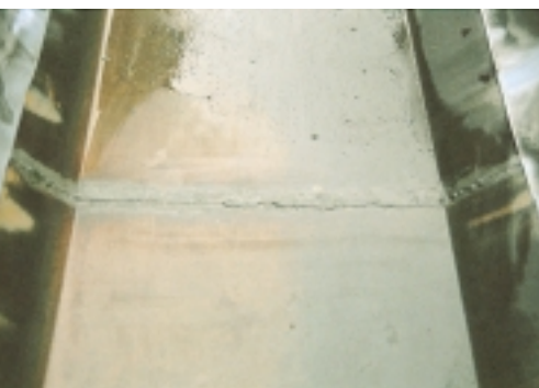
Soldeernaad in een koperen goot. Links vrijwel geheel opgelost doordat er (te lang) water in de goot blijft staan
