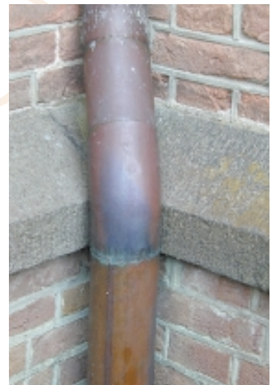
De blauwe kleur op het koper verraadt de aantasting door rioolgassen die via de hemelwaterafvoer omhoog stijgen
