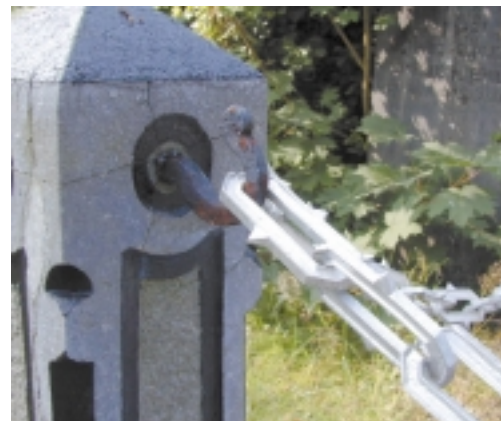
Ijzer zet uit door roestvorming. De verankeringen in natuursteen veroorzaken dus schade; de steen springt als gevolg van het uitzetten. Rond het dookgat is deze schade te zien. De kettingen zijn hier vervangen door goedkope aluminium kettingen
