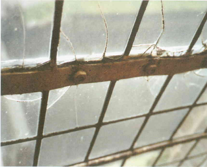
Het roesten van ijzeren brugstaven leidt tot forse uitzetting van het ijzer, waardoor het fragiele glas kapot gedrukt wordt (Foto H.J. Tolboom)
