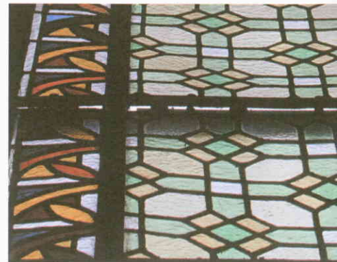
Verzwakking van het loodnet leidt tot uitbuiken en verzakken. Hier is het paneel losgekomen van de bevestiging en kan langs het paneel naar buiten worden gekeken. Binnendringend regenwater heeft hier vrij spel
