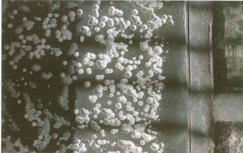
Chemische schade: aantasting in de vorm van putcorrosie (Foto R. Crèvecoeur)
