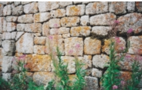
Ook graniet verruwt na enkele eeuwen wanneer het wordt blootgesteld aan een extreem klimaat (Mont Lozère, Frankrijk)
