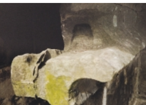
Deze zandstenen lijst is door overvloedig spoelen met water voor een groot deel verdwenen; een harde ader in de steen is blijven staan
