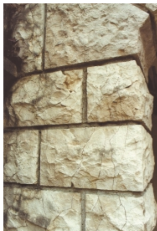
Wanneer de poriën volledig gevuld zijn met water of de poriënstructuur van natuursteen de volumevergroting van bevrozend water in de steen niet kan opvangen, zoals hier bij Anstrude, kan vorstschade optreden (foto: H.J. Tolboom)
