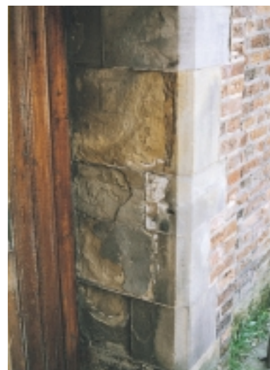
Doordat het uitgaanspubliek dit hoekje gebruikt als openbaar toilet, springen door de extreme zoutbelasting de schollen van de steen
