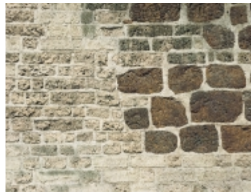
Opname van een muur waarin ijzeroer (rechts) en tufsteen is verwerkt (foto: H.J. Tolboom)
