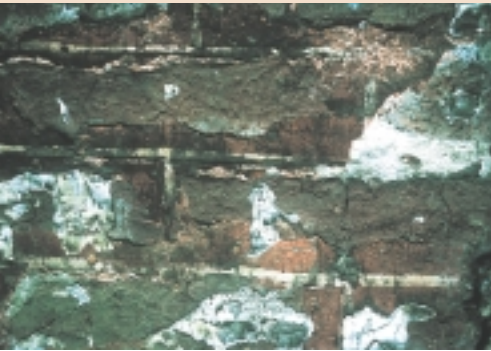
Een interessante historische schildering is deze baksteen-materiaalimitatie. Men heeft op een bakstenen ondergrond helderrode baksteen met witte voegen geschilderd
