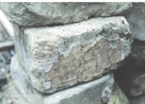
Ter bescherming is op de Gobertanger steen van de Sint-Gertrudiskerk te Bergen op Zoom een slink pakket verflagen aangebracht, afkomstig van oorspronkelijke en latere afwerkingen (foto Evert Jan Nusselder)
