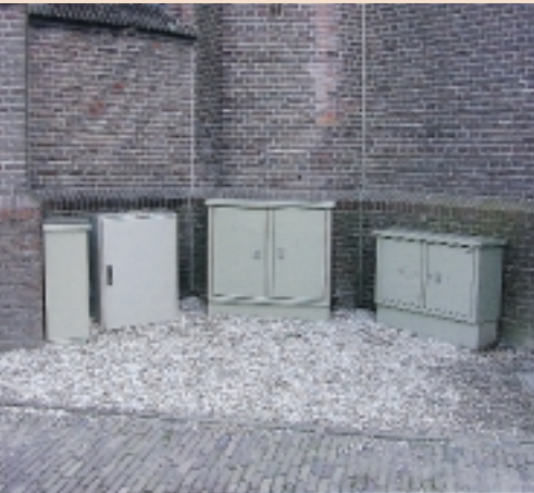
Sitesharing? Vier aanbieders in de toren, evenzoveel kasten buiten. Géén schoonheidsprijs.
