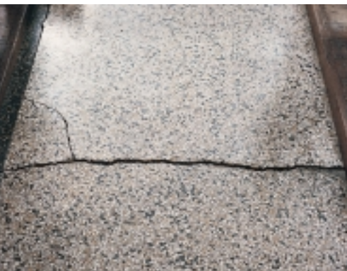
Gangpad in een kerk met forse breuk. Uit onderzoek bleek dat deze breuk zich bevond boven het scheidingsvlak van twee verschillende funderingsconstructies.
