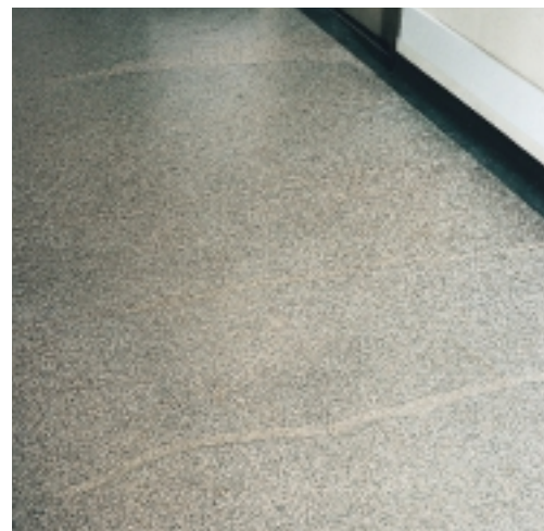
Gerepareerde scheuren. De scheuren zijn waarschijnlijk ontstaan als gevolg van het krimpen van te nat verwerkte terrazzo.
