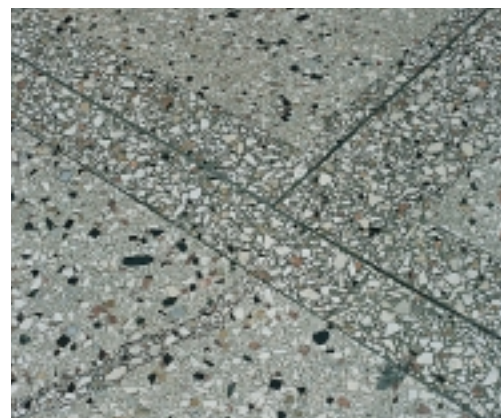
Detail van een gerepareerde vloer. Hier is gekozen voor hetinzagen van de scheuren, het vernieuwen van de smalle velden en tevens het aanbrengen van een dilatatie, echter midden in de gerepareerde strook.
