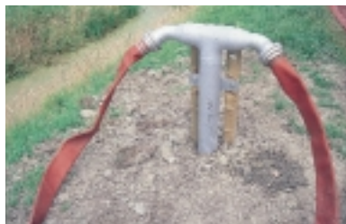
Het hart van een blusinstallatie bij een molen: de brandweeraansluiting
