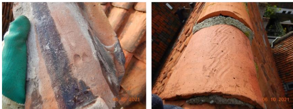
Tijdens de inspectie van een 15e eeuwse woonhuis in Elburg troffen de monumentenwachters diverse vingerafdrukken en versieringen aan in de dakpannen. De vingerafdrukken ontstonden vaak door het vastpakken van de nog zachte dakpan uit de mal. De versiering op de nokvorst is waarschijnlijk met opzet aangebracht.
